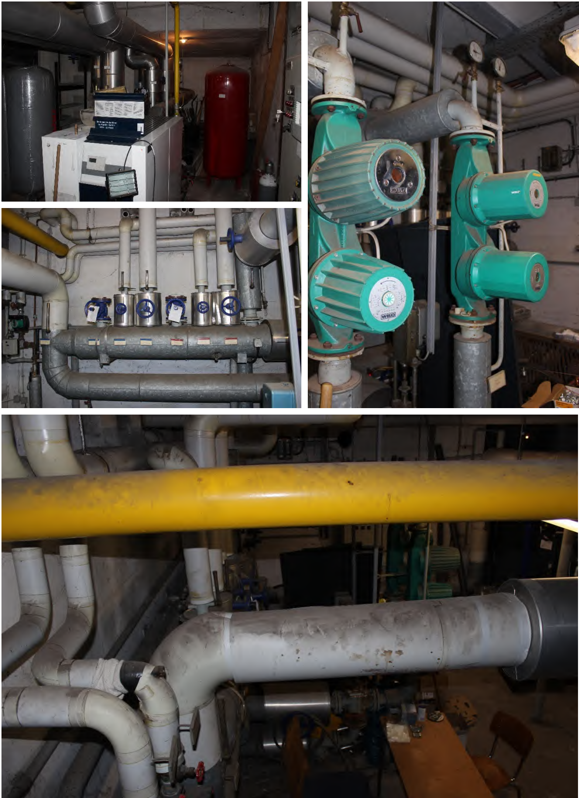
Abbildung 4: Aufnahmen Heizungskeller Quelle: FRANK Ecozwei GmbH
