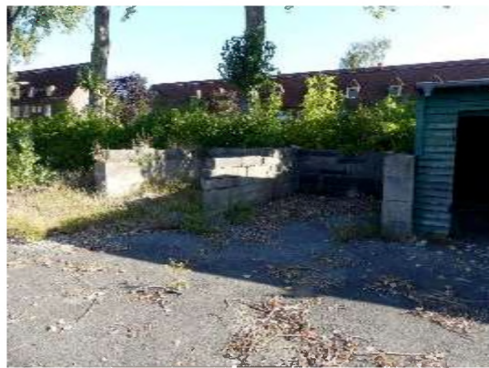
Versiegelung bis an Grundstücksgrenze
