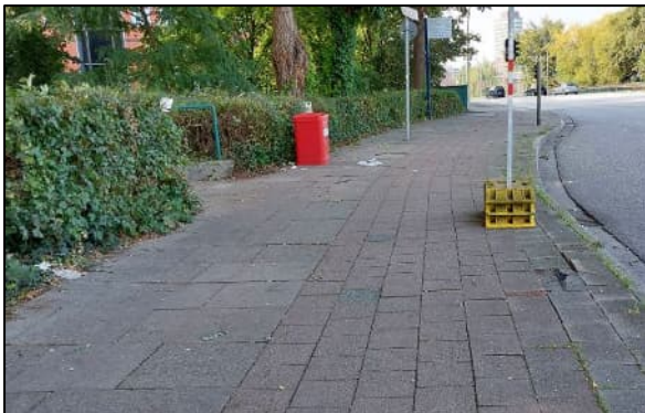
Abb. 17: Knotenpunktinnenraum, Blick Richtung Norden, westliche Nebenflächen mit Unebenheiten durch hochgedrückte Baumwurzeln
