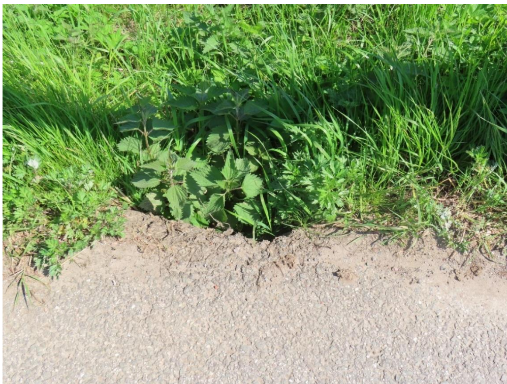
Abbildung 32: Exemplarische Absackung einer Straße im Stadtteil Allermöhe, Bezirk Bergedorf. Quelle: LEWATANA, 2023.
