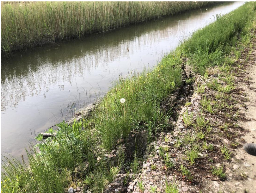
Abbildung 34: Weggesackter Straßenrand an einem Graben im Stadtteil Neuenfelde, Bezirk Harburg. Quelle: LEWATANA, 2023.
