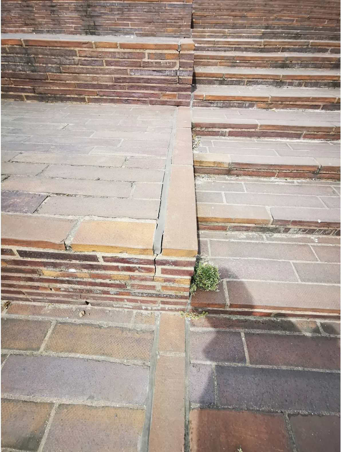
Abbildung 3.3: Foto – Schaden Sitzstufen Übergang Östliche Treppe (Stand 10.05.2022)
