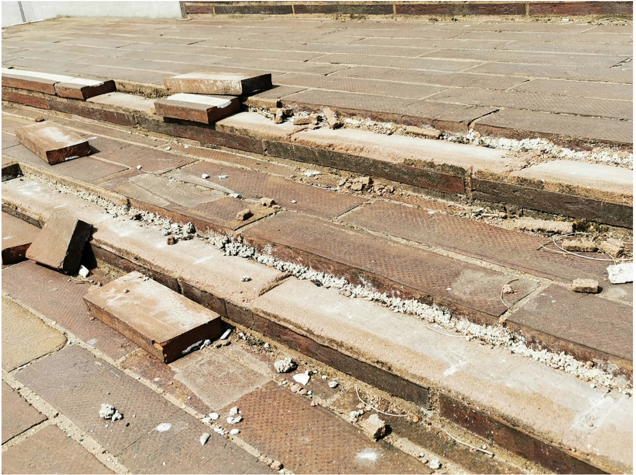
Abbildung 4.2: Foto – Schaden westliche Treppe (Stand 10.05.2022)
