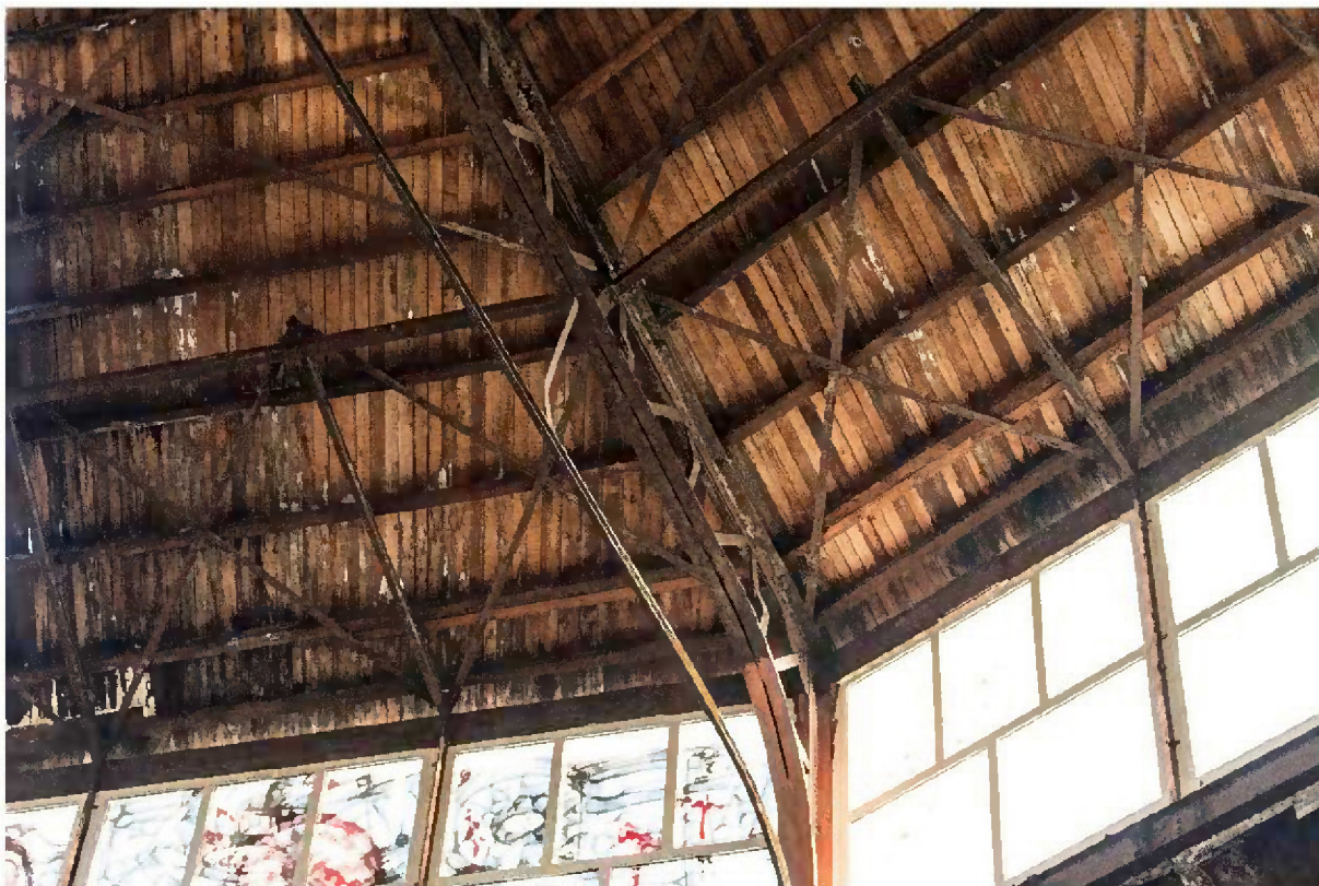
Fachwerkbinder am Anschlusspunkt der inneren Kreuz-Stützen (Fachwerk-Diagonalen teilweise ausgeknickt)
