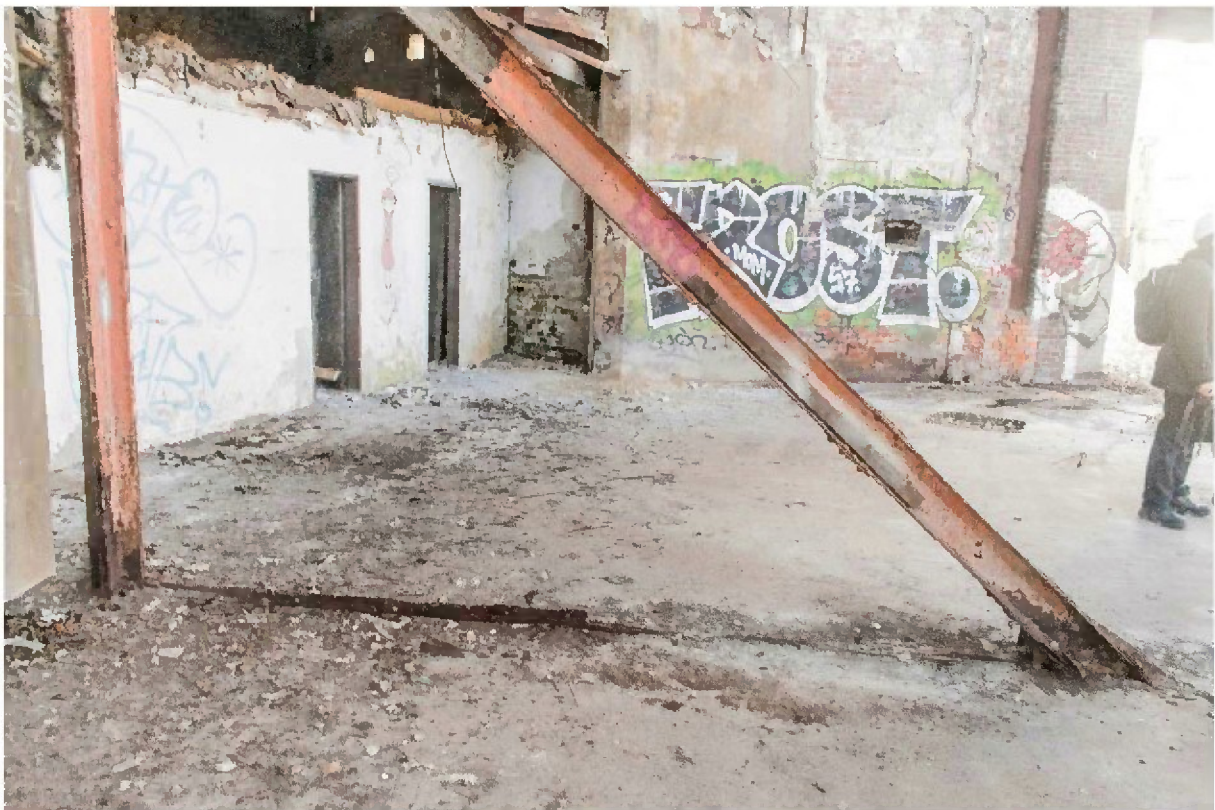
Seitenansicht des unteren Tribünenträgers mit in Fußbodenebene verlaufendem Zugband (fortgeschrittene Korrosion)
