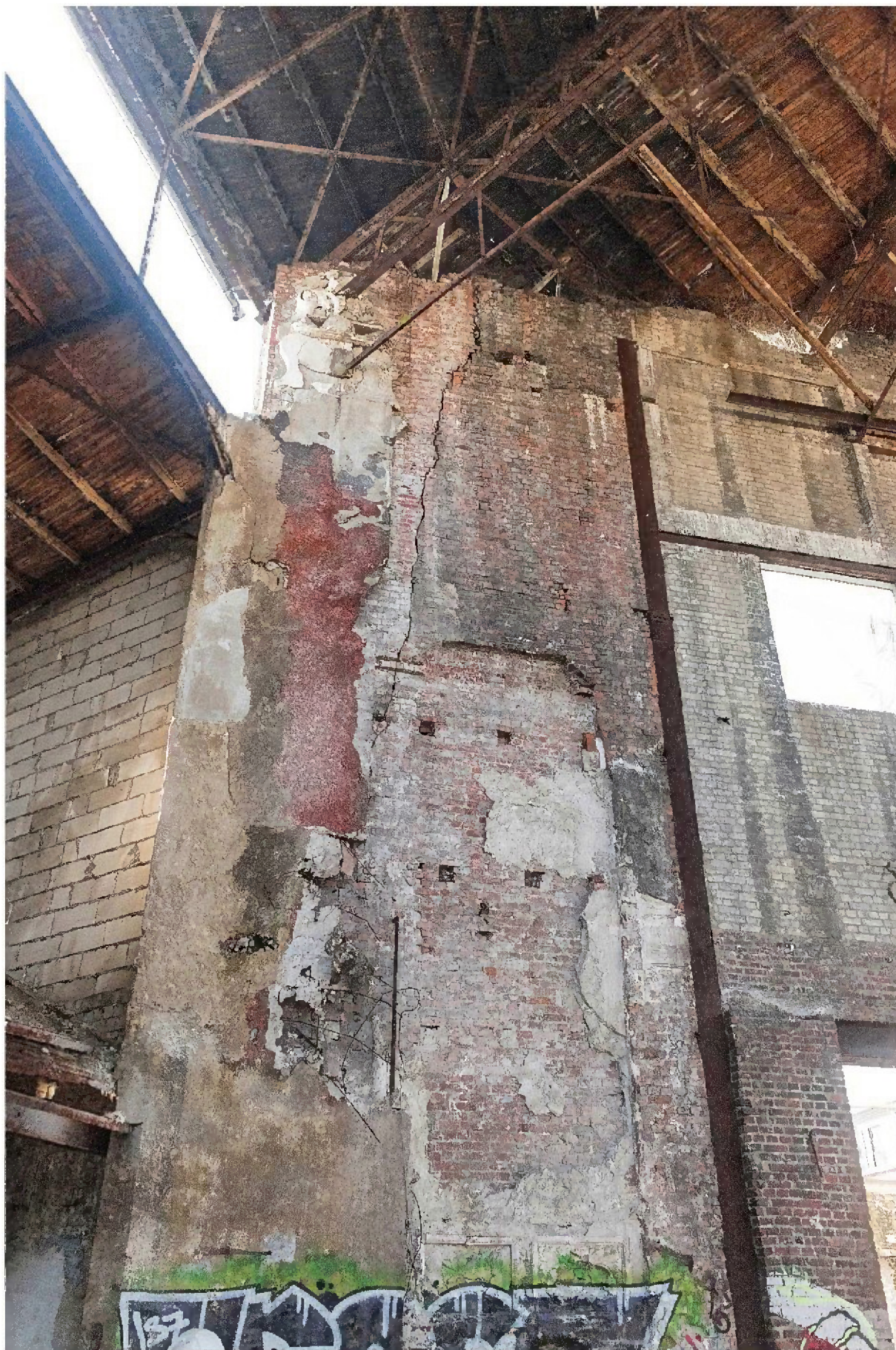
Linke Seite des Portals (ehem. Bühne) mit vertikal verlaufendem Riss
