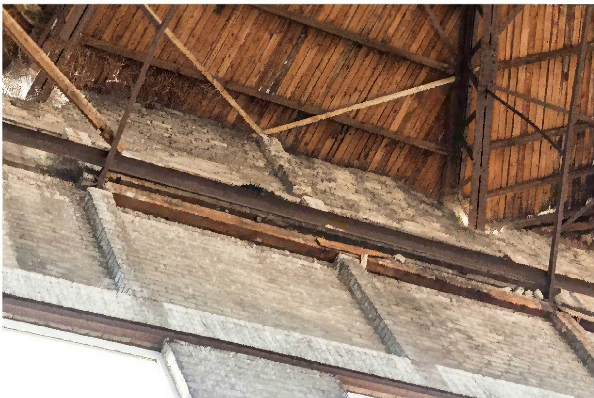
Träger ohne erkennbare Funktion oberhalb der Oberlichter des Portals liegt auf der Unterdecken-Unterkonstruktion auf
