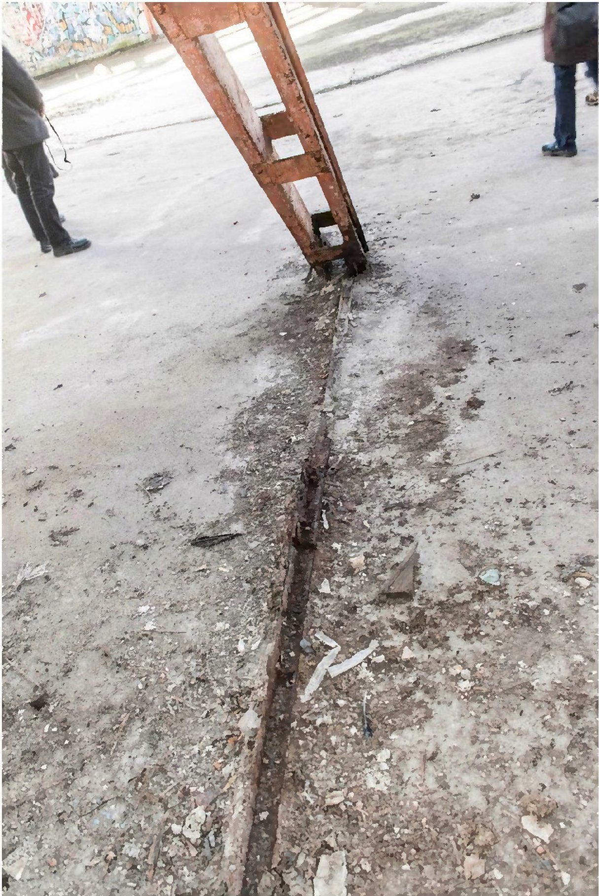
Blick entlang des in der Fußbodenebene verlaufendem Zugbands des unteren Tribünenträgers (fortgeschrittene Korrosion)
