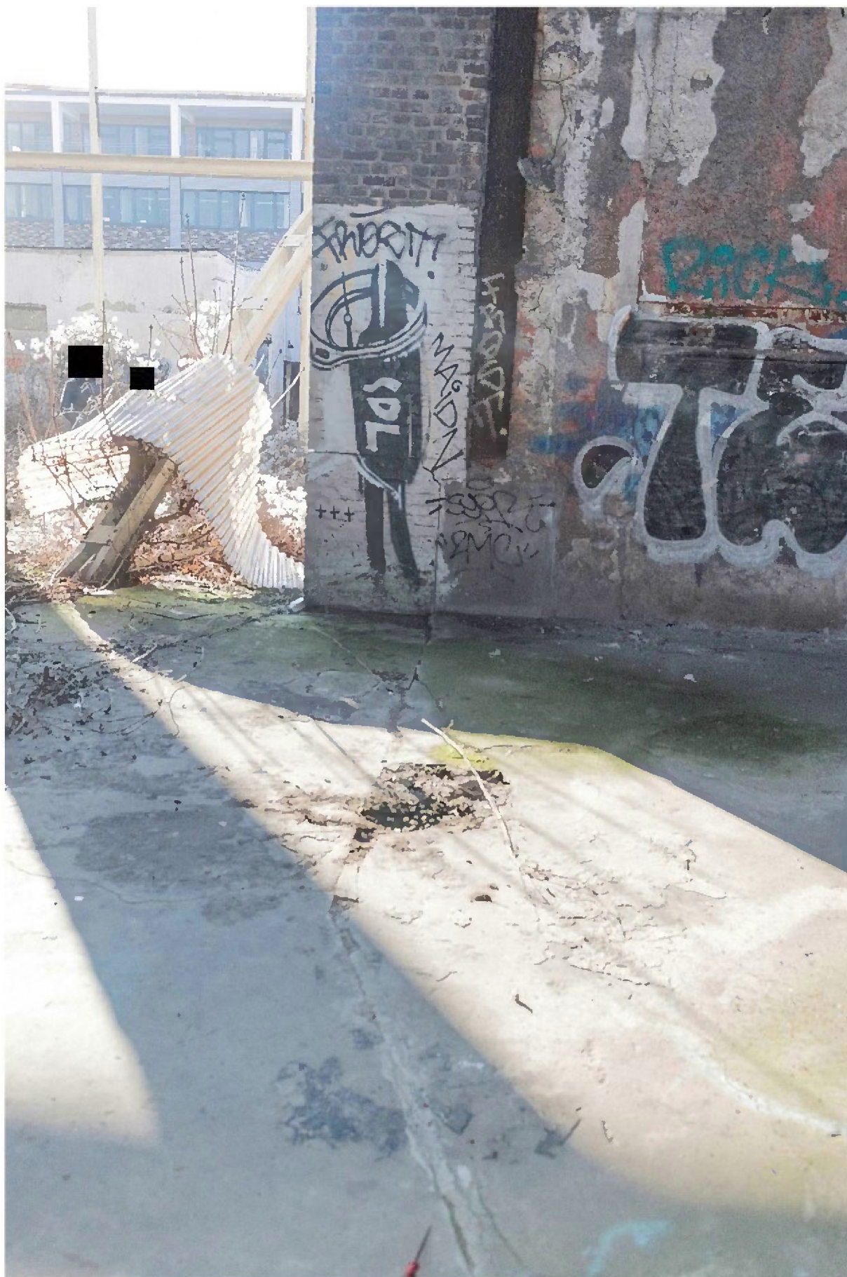
Rechte Seite untere Ecke des Portals (ehem. Bühne) mit Riss in der Bodenplatte und im angrenzenden Mauerwerk
