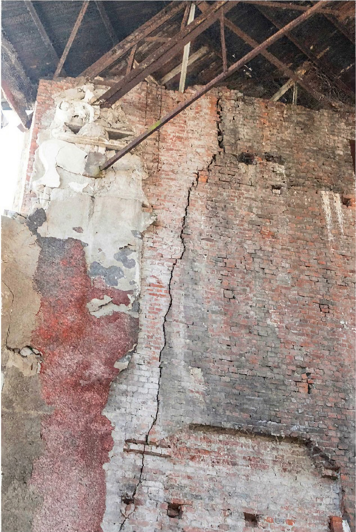
Nahaufnahme des vertikal verlaufenden Risses
