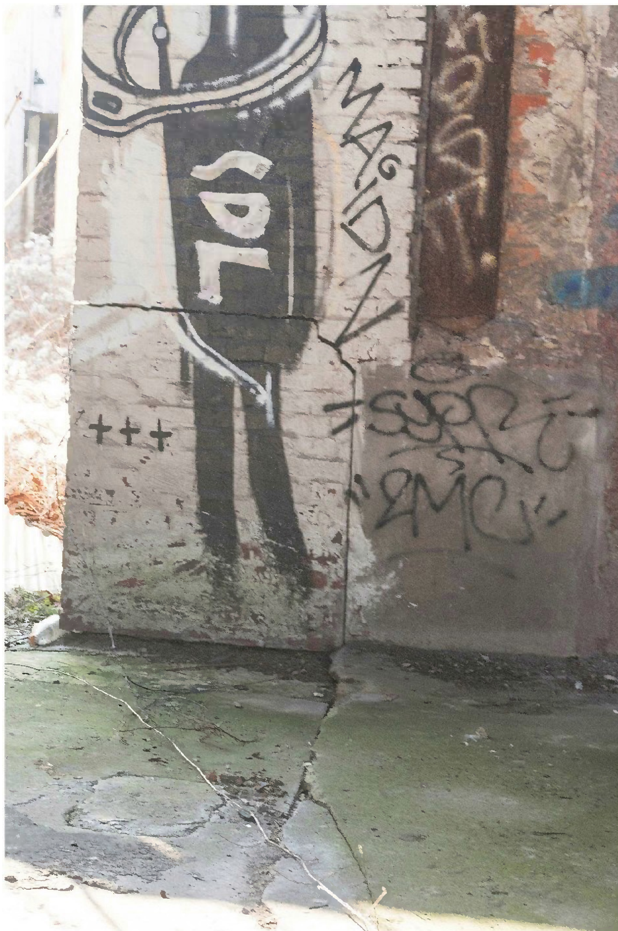
Detailaufnahme des Risses in der Bodenplatte und im angrenzenden Mauerwerk
