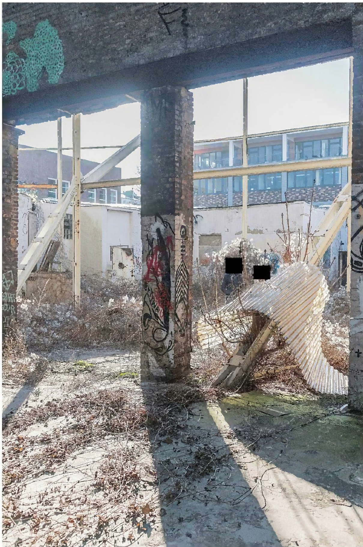
Erste Stütze von rechts unter dem Abfangeträger des Portals (mehrere Horizontalrisse über die gesamte Stütze erkennbar)
