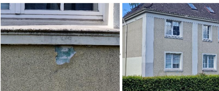
Abbildung 4-8: Beispiele baulicher Defizite
