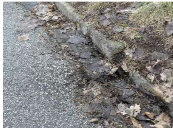
Angehobener Bordstein und Asphaltanhebungen
