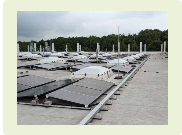
Abb. 4.2: Abgedeckte und aufgeständerte Kabelrinne
