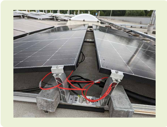
Abb. 4.2: Detail: Verkabelung mit Erdung, UK und Ballastierung
