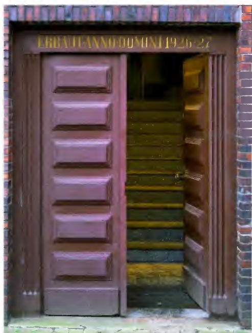
Abb. 30: Eingangstür neues Sudhaus
